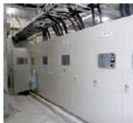
キュービクル式高圧受電設備
